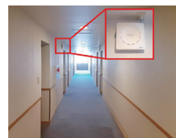
「WAPM-AX8R」は廊下の両壁に交互に設置し、電波の死角を無くした
