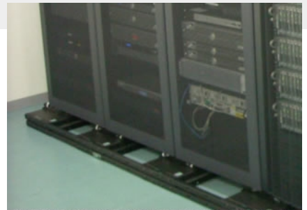
防震システムをISO-BASEを採用したラックにお客様の大切なデータを保管されています
