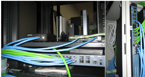
2Fのフロアスイッチとして使用されているBS-G2124Mと光回線へ変換する光トランシーバーBS-SFP-GSR (左)。各階のフロアエッジスイッチであるBS-G2124M (右)。
