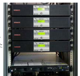
4台の(TeraStation IS) TS-R14.0GL/R5とそその下にIBM製サーバー
