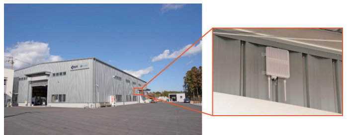
工場の外側の壁に「WAPM-1266WDPR」を設置し、加工室と駐車場をカバー。-25～+55℃まで対応の「WAPM-1266WDPR」なら、最低気温が-5℃を下回ることもある御殿場の冬にも耐えられる。
