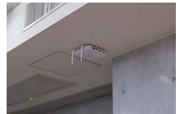
同時接続数が多い「WAPM-1266R」を採用することでスッキリした外観を実現
