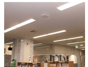
1Fネットワークギャラリーに設置された「WAPM-1266R」
