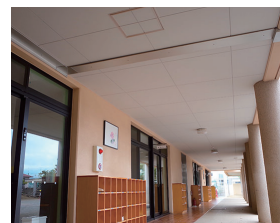
無線LANアクセスポイントは教室をつないでいる廊下の天井に見えないように設置。
