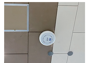
天井に設置された、法人向け無線LANアクセスポイント「WAPM-2133TR」。
