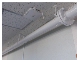
適度な間隔で「WAPM-1266R」を配置し、施設内全域に安定したWi-Fiを提供
