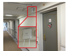
居室各フロアの天井や壁に設置された「WAPM-1266R」
