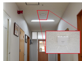
本館4フロア、リハビリ棟の2フロアに11台の「WAPM-1266R」を設置した
