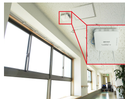
全施設で「WAPM-1266R」を採用し、廊下天井などに設置した
