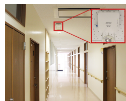
「WAPM-1266R」を適所に設置し 全域でつながるWi-Fi環境を構築
