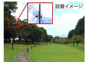
散策道に建てたポールにカメラと「WAPM-1266WDPRA」を設置
