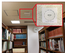
天井に設置されたWi-Fi 6(11ax)対応のWi-Fi機器「WAPM-AX8R」
