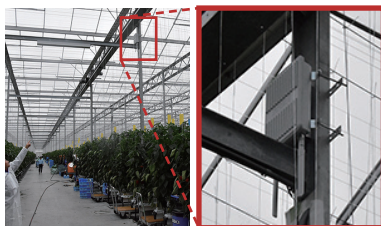
パブリカトマトハウスの約6mの高さに「WAPM-1266WDPDR」を設置
