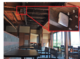
1階・2階天井に「WAPM-AX8R」を設置し、店内に安定したWi-Fiを提供
