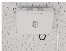
電波調査で通信速度・安定性に問題がないことを確認し、「WAPM-1266R」1台で2教室をカバー。
