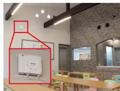
「WAPM-AX4R」を園内各所に設置し電波強度を確保
