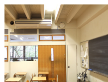
60台の端末と同時接続するために、各教室に2台の無線LANアクセスポイントを設置。
