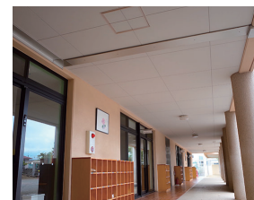
無線LANアクセスポイントは教室をつないでいる廊下の天井に見えないように設置。
