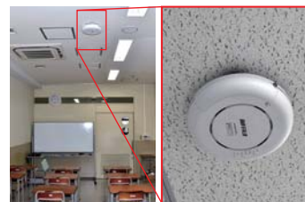
予備教室に設置した無線LANアクセスポイント。入念な導入設計により、安定稼働しています。
