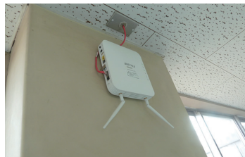
廊下に設置された無線LANアクセスポイント「WAPM-1266R」。2教室につき1台設置されている。
