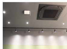
どこでも安定してWi-Fiを利用できるよう無線LANアクセスポイントを6台設置。
