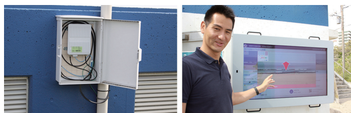
直射日光を避けるため防護ボックスに収めて監視所の離岸流の発生および人の立ち入りを検知した際は、監視所外壁に設置された「WAPM-1266WDPR」。監視所とプール管理事務所では「WLE-HG-DA/AG」を使用所サイネージへ表示すると同時に、ライフセーバーが持つ腕時計型ウェアラブル端末へ通知
