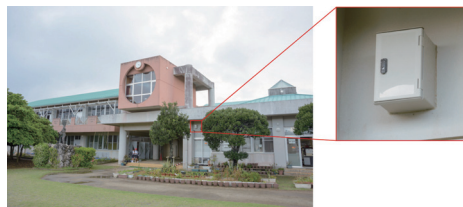
国頭小学校では、屋内に設置した「WAPM-1266R」に、屋外用アンテナ「WLE-HG-DA/AG」を接続。アンテナは専用同軸ケーブル「WLE-CCシリーズ」で屋外の防護ボックス内へ引き出している。
