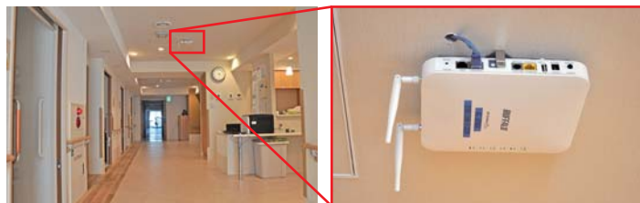
無線LANアクセスポイント「WAPM-1266R」は、個室のある廊下の天井に設置されている。個室12部屋を2台でカバーし、合計20台が導入されている。他の機器からのノイズを検知する「干渉波自動回避機能」などを備え、安定した通信を実現する。
