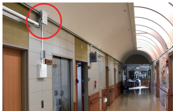
廊下やホールに11台の無線LANアクセスポイント「WAPM-1266R」×11台を配置
