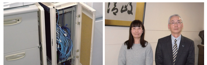
通常は扉が閉められており、通信機器があると気付かれないよう設置している
