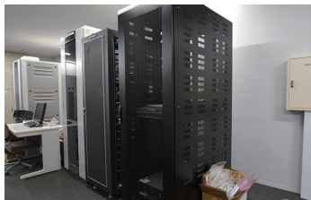
地下のサーバー室に設置されたラックにTS51210RH4812がマウントされている。
