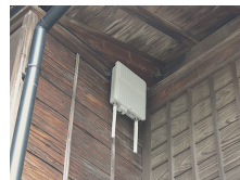
旅館内の中庭に設置した「WAPM-1266WDPR」。
