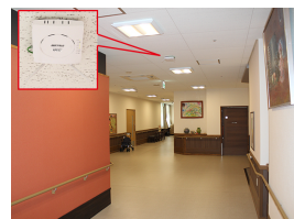
「WAPM-AX4R」を用いて施設全域の通信をカバー
