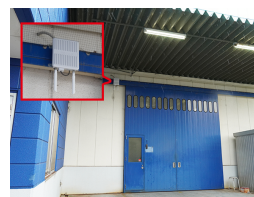
高所に設置し、搬入トラックなどで電波を遮られるリスクを無くした
