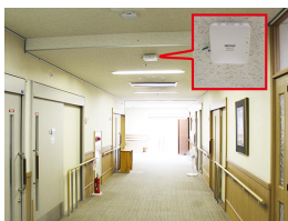
「WAPM-1266R」を廊下の天井に設置
