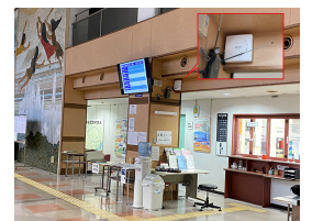
「WAPM-AX8R」を1階ロビーに固定設置し公衆Wi-Fiを提供
