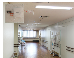
12台の「WAPM-AX4R」で本館・西館をまたぐ広範囲の通信をカバー
