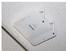
無線LANアクセスポイントの配線を隠すため、セキュリティーケース「WLE-OP-SCA2」を導入。
