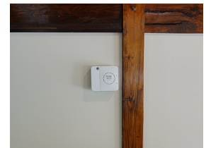
壁面に設置された、法人向け無線LANアクセスポイント「WAPS-1266」。
